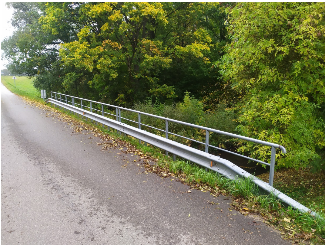
5 pav. Tilto turėklai be vertikalaus užpildo, atitvarai per žemi, želia žolė
