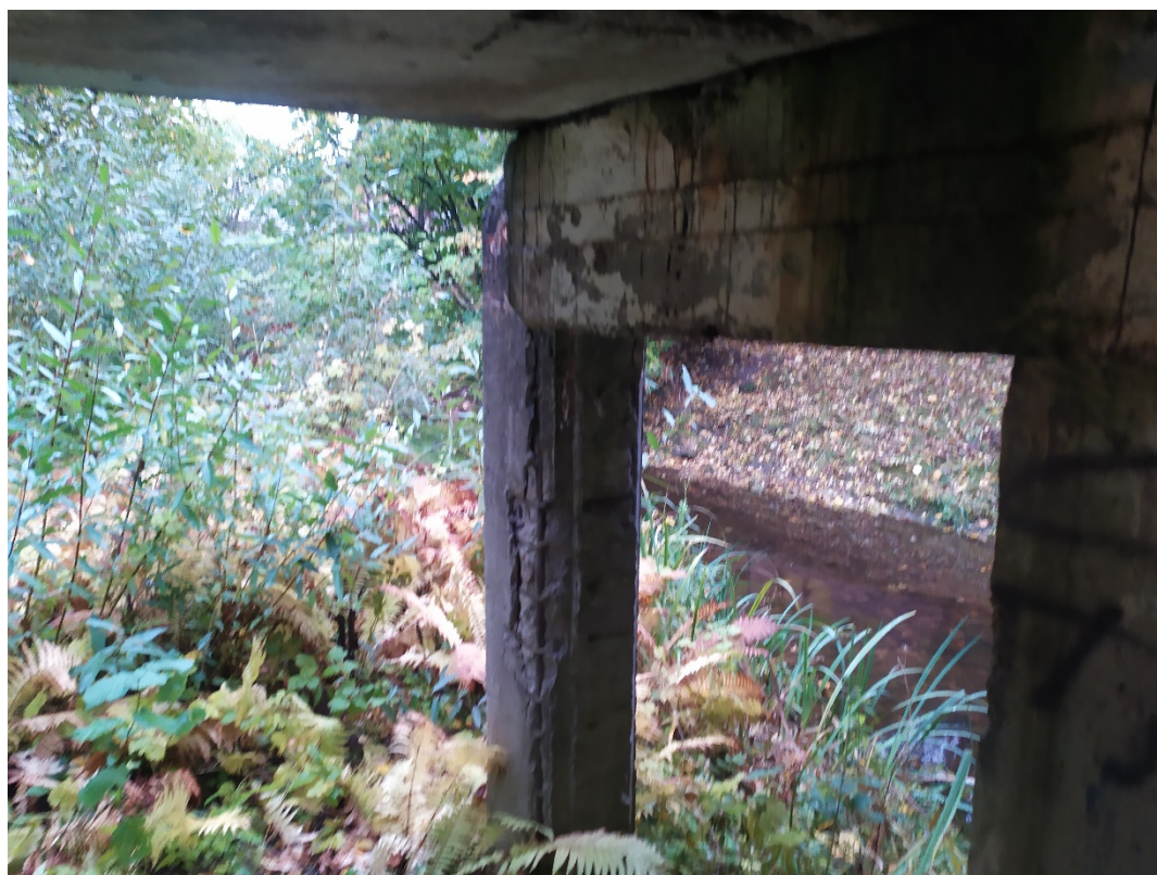
10 pav. Pažeisti tarpinės atramos poliai
