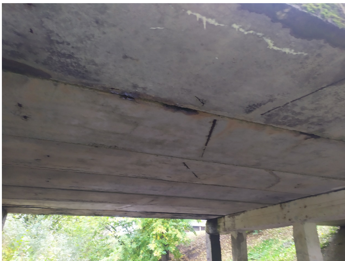
8 pav. Perdangos plokščių pažaidos
